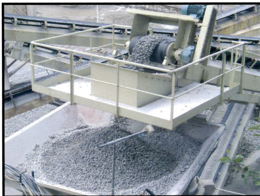
Fotografia nº 5: Vista de pormenor da instalação de britagem
